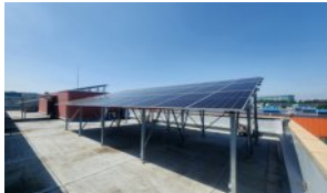
대동기어 태양광 발전설비
